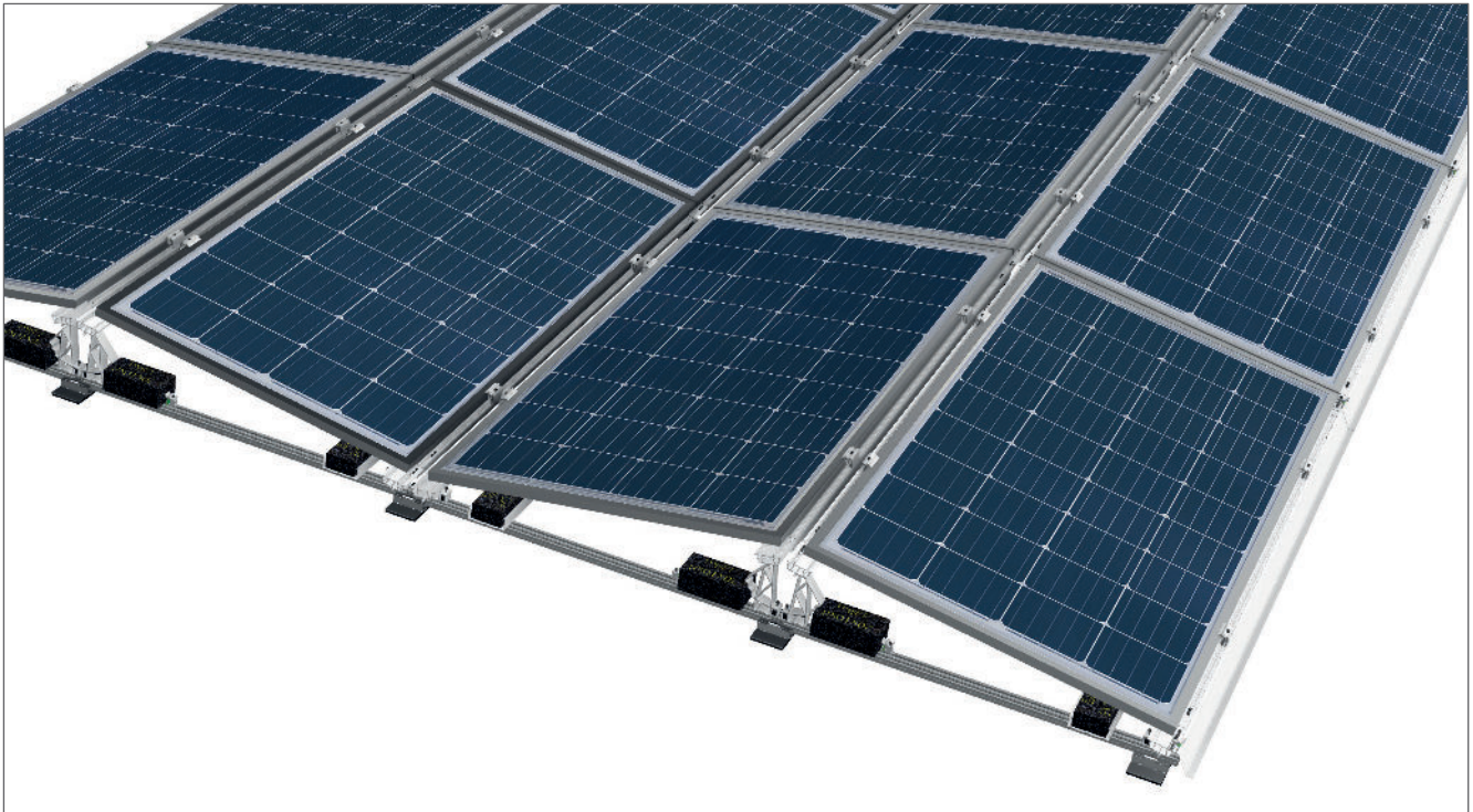
Aufbau: Ausrichtung Ost/West
